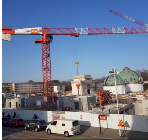
Le chantier de Grand Nancy Thermal, ce mardi 2 mars. Photo ER/Corinne BARET
