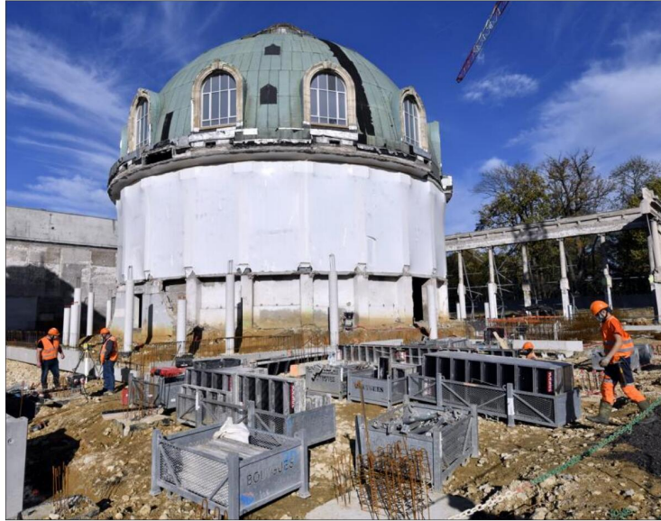
Les coupoles de la piscine ronde ont été conservées. Photo ER/Alexandre MARCHI
